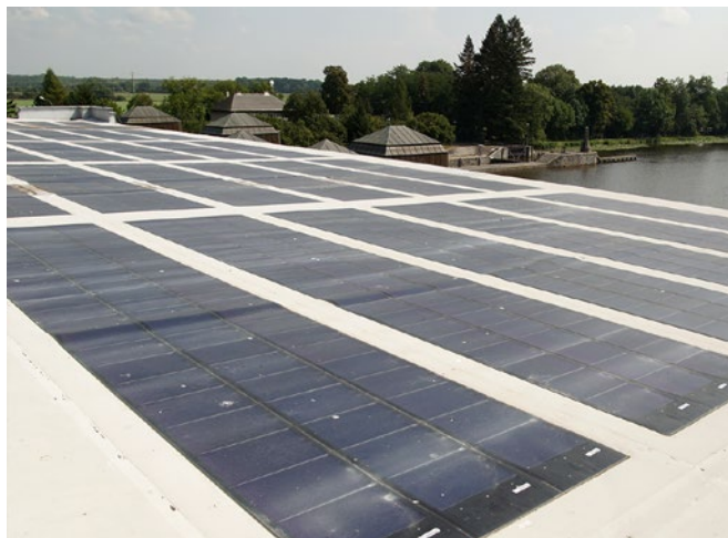
Na střeše technické památky Malé vodní elektrárny Přelouč na řece Labe z roku 1924 instalovala společnost ČEZ koncem roku 2009 novou solární elektrárnu. Zařízení o instalovaném výkonu 21 kW si vyžádalo investici 5,1 milionu Kč. Na jednom místě se tak zde získává elektrická energie ze dvou druhů obnovitelných zdrojů.
