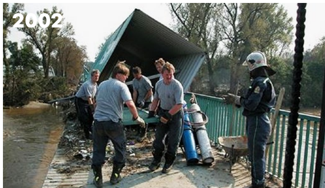
2002 Po tisícileté povodni v roce 2002 na lávce uvízla stavební buňka. Lokální zatížení bylo mnohonásobně vyšší, než se dalo při návrhu konstrukce předpokládat.
