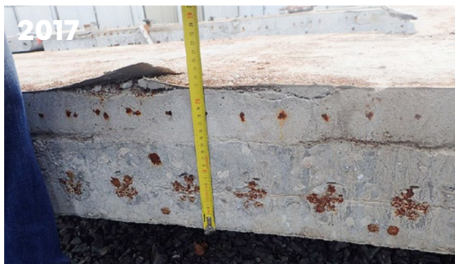
Při opravě v roce 2012 bylo v některých částech nahrazeno až 50 % nosného průřezu staticky nefunkční sanační maltou, a to bez statického posouzení.
