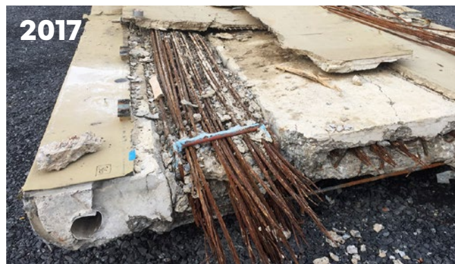
Zbytky stavby byly bohužel odstraněny krátce po havárii. Zkorodovaná lana a spára, ve které byl staticky nefunkční sanační beton umístěn na okrajích segmentu po celé výšce průřezu.
