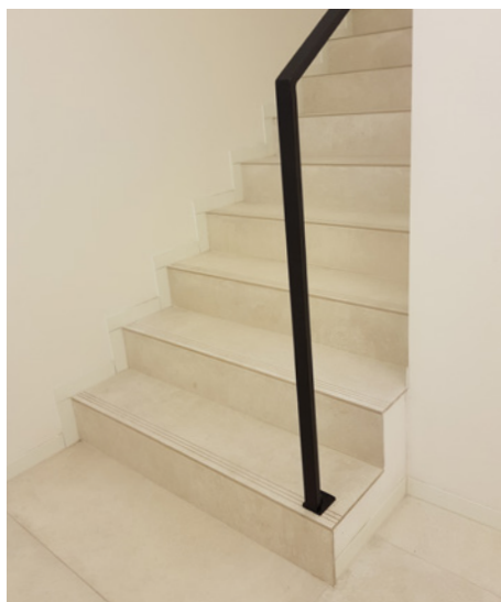
Častá a opakující se chyba řešení schodišťového prostoru bytových domů – chybějící oboustranné zábradlní madlo s přesahem a kontrastní značení stupnice nástupního a výstupního schodišťového stupně.
