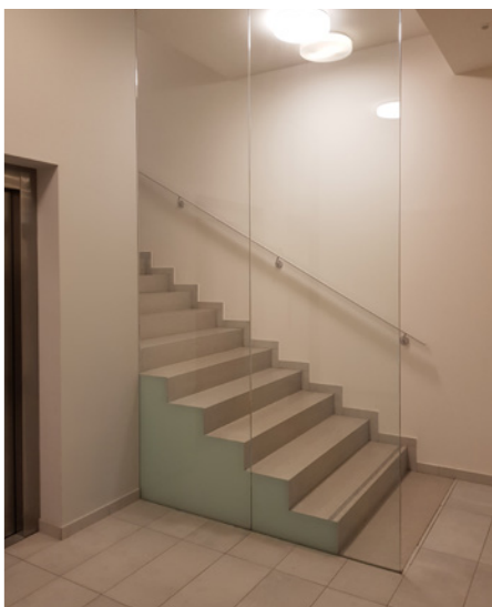
Nerespektování zásad bezbariérového užívání domovních komunikací osobami se zrakovým omezením – nekontrastní prosklená stěna dělící schodiště je pro slabozraké uživatele nebezpečným prvkem.
