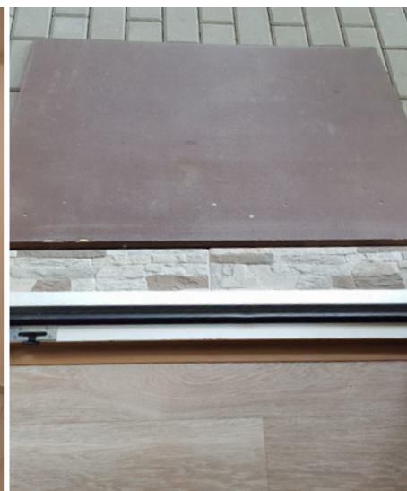
Nesplnění požadavku bezbariérového užívání terasy bytu zvláštního určení – přístupnost musí být v úrovni podlahy bytu s výškovým rozdílem nejvýše 20 mm.
