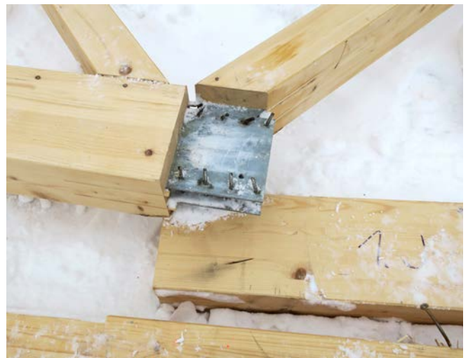
Obr. 9 Porušení spoje spodního pasu po havárii (foto: Jan Chaloupský)
