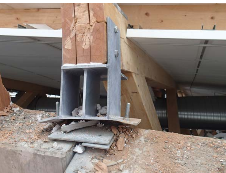
Obr. 11 Uložení vazníku na podporu po havárii (foto: Jan Chaloupský)
