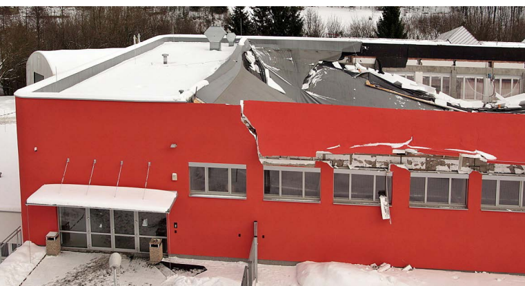
V lednu 2017 se v České Třebové krátce po kolaudaci zřítila střecha tělocvičny s hrací plochou 23 x 42 m. Nová střešní nosná konstrukce haly je tvořena sedlovými vazníky z lepeného lamelového dřeva s rovnou spodní pásnicí, staticky působící jako prosté nosníky. Rozpětí vazníků je 25,2 m, rozteč 3 m. Tvar vazníku je sedlový se sklonem 3°. Vazník je uložen na obvodovém železobetonovém průvlaku. Prostorové ztužení konstrukce zajišťují podélná ztužidla po 2,5 m a zavětrování z ocelových táhel ve čtyřech polích. Skladba střešního pláště je řešena stejně jako u původní střechy. (zdroj: Mgr. Dominik Barták, tiskový mluvčí Pardubického kraje)
