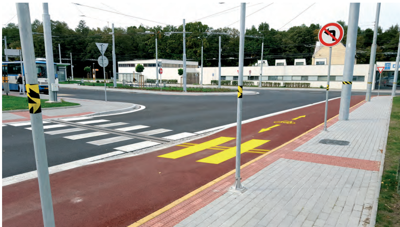
Příklad nevhodně řešeného přechodu pro chodce nerespektující ČSN 73 6110 a ustanovení v čl. 10.1.3.1.10. Přechod pro chodce se nesmí zřízovat tam, kde je v přidruženém prostoru dovolen provoz cyklistů a není možno zřídit vyčkávací prostor pro chodce.
