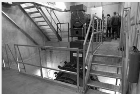
Malá vodní elektrárna ve Svijanech – interiér (foto: Ing. Stanislav Gajzler, Ing. Karel Zikmund)
