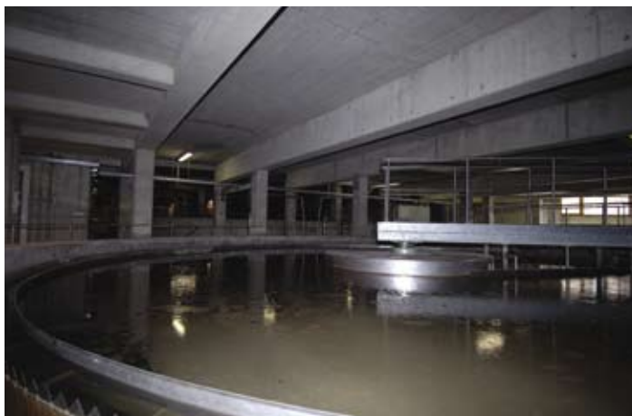
Čistírna odpadních vod v Náměšti nad Oslavou, podzemní dosazovací nádrže
