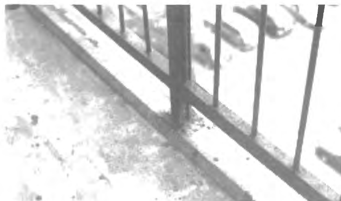
Původní stav lodžii – kritický stav zábradlí
