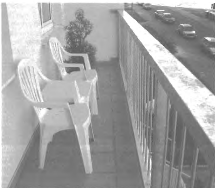
Konečný technický stav lodžii
