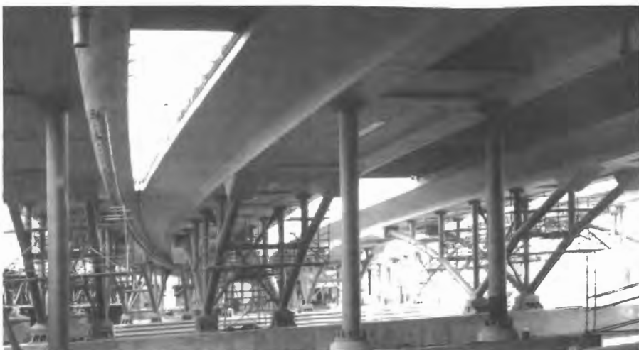
Svislé ocelové sloupky a most nástupiště v oblouku
