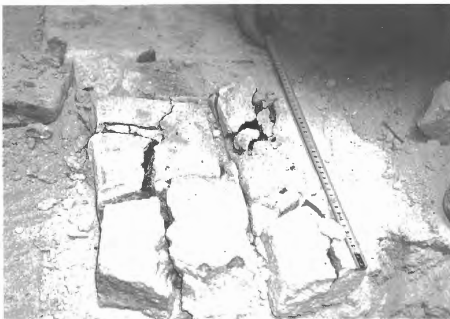
Porušené vrstvy v ložné vrstvě nad táhlem (pilíř „00“)
