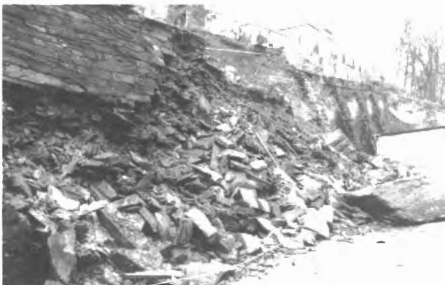
TATO JEDENÁCT METRŮ VYSOKÁ OPĚRNÁ ZEŇ v oblasti bytové zástavby se zřítíla, protože v blízkosti svahu byly prováděny neodborné šachtové výkopy – takové chyby zkoumá Institut pro výzkum poškození staveb ve Výmaru velmi přesně, aby mohl vyvinout preventivní opatření
