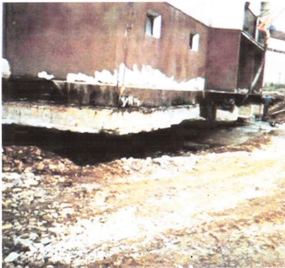
Panelový dům T-06B v Hanušovicích – povodněmi r.1997 byla 1/3 základové spáry podezlela, dům vydržel přibližně týden, než bylo provedeno podbetonování
