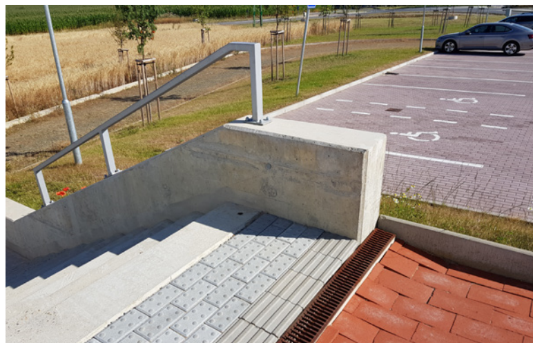
Nepochopení principu užití hmatových úprav v rámci veřejných prostranství. Před schodišťovým ramenem je použita dlažba s podélnými drážkami šířky 200 mm (užití pouze pro umělé vodicí linie!) a na ní těsně před schodišťovým stupněm navazuje varovný pás šířky 400 mm. Hmatové úpravy formou varovného pásu se v českém prostředí u venkovních schodišť používají pouze tehdy, pokud schodiště vede do komunikace (např. parkovací plocha) bez jakékoliv návaznosti na chodník. (foto: archiv autora)
