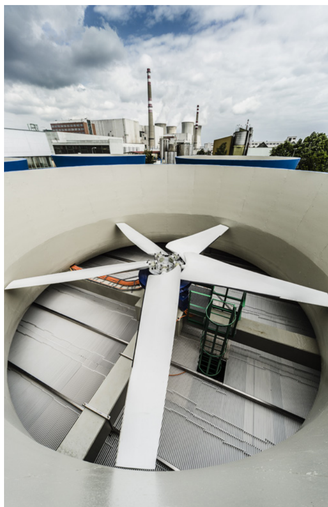
Pohled shora do jedné z 12 chladicích ventilátorových věží, které byly dokončeny v roce 2016. Každá je schopna samostatně zajistit dochlazení jaderného bloku a jeho bezpečnostních systémů. Generálním dodavatelem a projektantem chladicích věží byla firma REKO Praha, a.s. (foto: Tomáš Malý)
