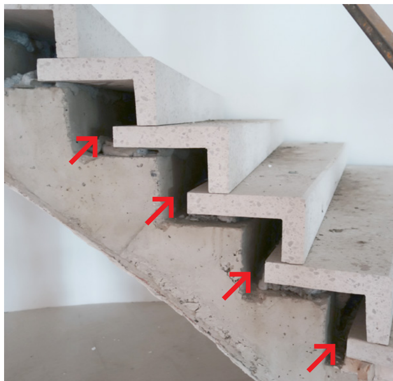
Příklad nevhodně realizovaného železobetonového točitého schodiště s prefabrikovaným obkladem z teraca, který nesedí správně na schodnicích. (foto: Linda Veselá)
