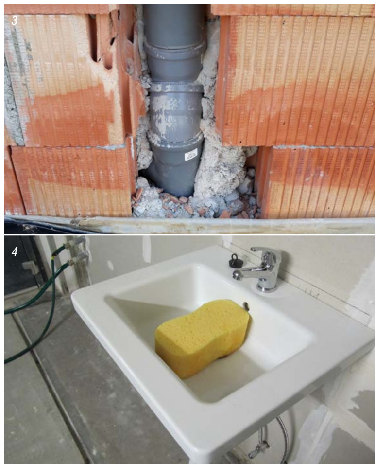
Kvalitní kanalizační rozvod zazděním do vyzdívký rázem ztrácí své akustické vlastnosti a hluk se může přenášet do okolních místností (foto č. 3).
