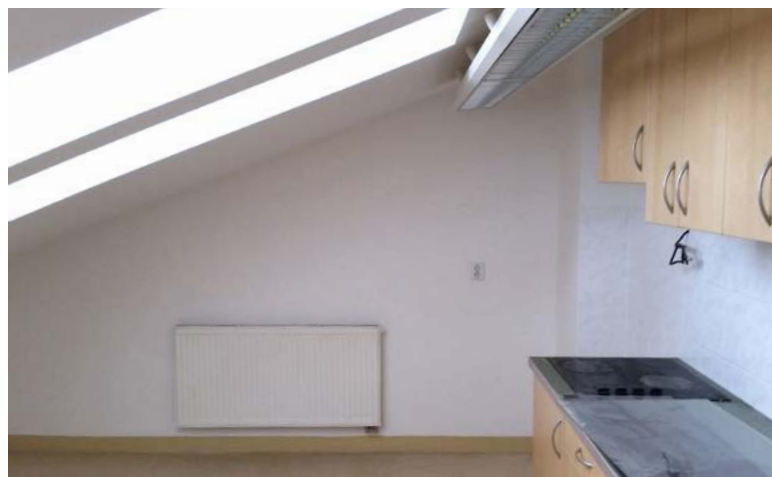
Nedodržení světlé výšky je vážným kolaudačním nedostatkem (foto: redakce)
