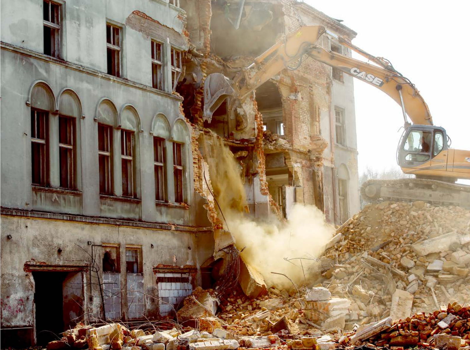
Během řízení o prohlášení bývalého kláštera Kongregace milosrdných sester sv. Kříže v Chebu kulturní památkou byla na jaře roku 2016 naprostá většina budov bývalého kláštera zbořena a řízení muselo být zastaveno, neboť přestal existovat důvod, pro který bylo řízení zahájeno (foto: Jan Buriánek)
