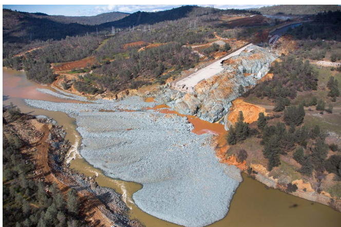
Poškození nejvyšší kalifornské přehrady Oroville vyvolalo evakuaci dvě stě tisíc lidí ..... 36
