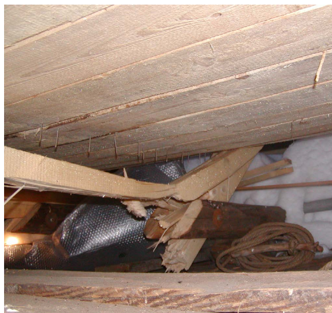
Zřícení krovu nové stodoly v roce 2001 bylo způsobeno neodborným prováděním bez dohledu oprávněné kvalifikované osoby
