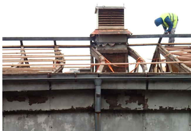
Střecha zemědělského objektu se v roce 2014 zřítla v důsledku neznalosti zhotovitele stavby, který při výměně střešní krytiny odstranil prkenná ztužidla
