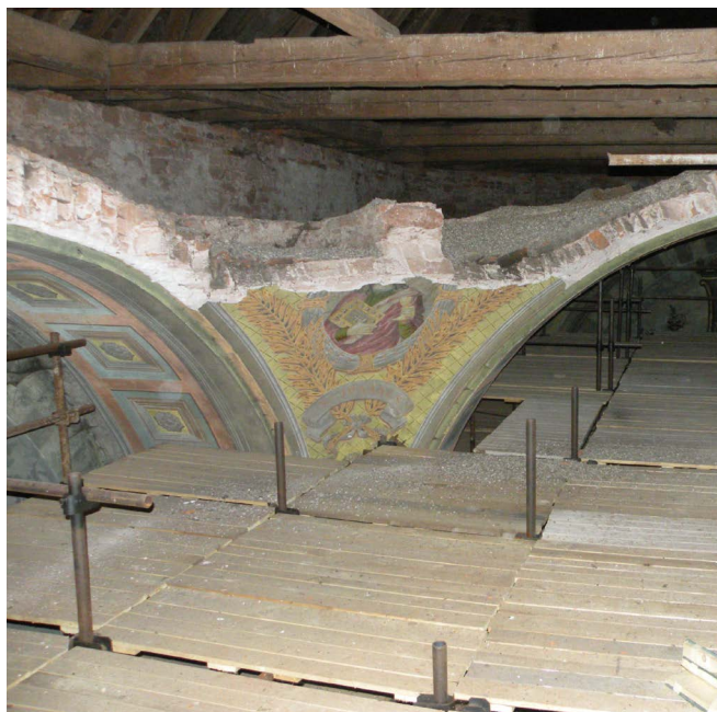
Klenba kostela se před deseti lety zřítila v důsledku dlouhodobě zanedbané údržby
