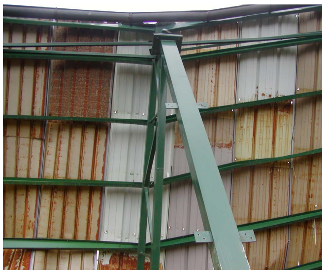
Ocelová hala jízdrny se zřítla v důsledku neodborného provádění a nedostatečné kontroly při provádění stavby před téměř deseti lety
