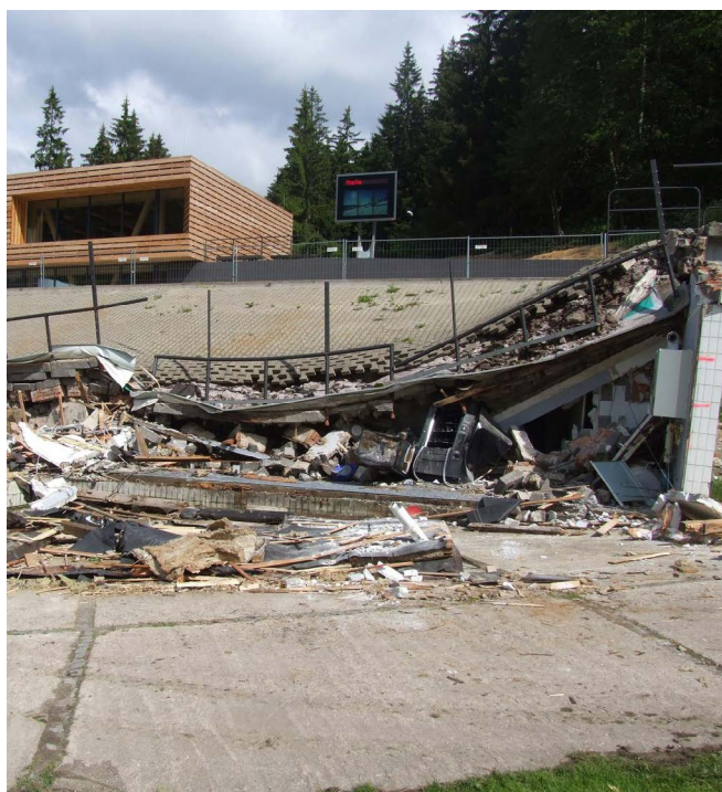
Zřícení pochozí střechy v roce 2015 bylo způsobeno dispozičními změnami a nedostatečnou únosností pilířů z tvárnic suchého zdění, které byly šestkrát až osmkrát přetíženy
