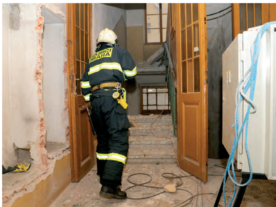
Dvouramenné schodiště z pískovcových stupňů se v pražském bytovém domě zřítlo po překročení limitu únosnosti schodišťových stupňů z vypočtených 340 kg/m 2 na skutečných 537 kg/m 2 (foto: HZS Praha)
