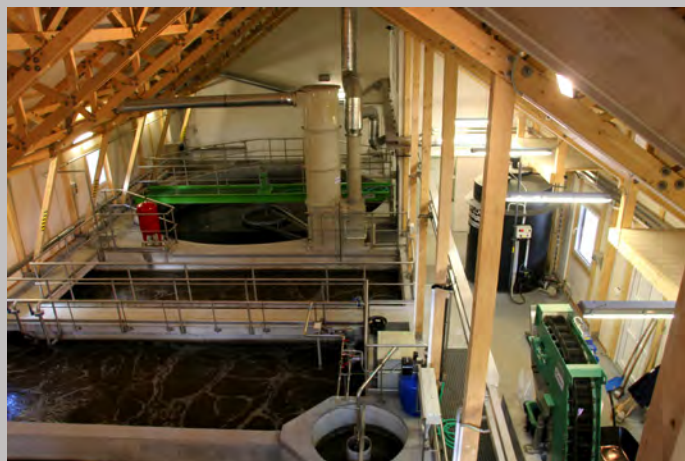
ČOV v Lidečce, realizace v rámci projektu Čistá řeka Bečva (zdroj: ČKAIT Zlín)
