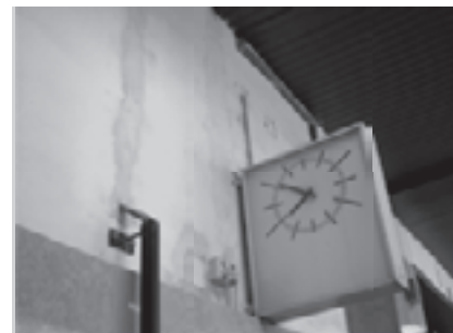
Budova nádraží z 19. století chátrá (foto: redakce)
