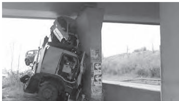
Na místě byl posouzen stav mostního pilíře po nárazu tahače
