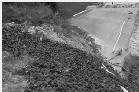
Čelo sesuvu v km 55,5 na téměř dokončené dálnici D8
