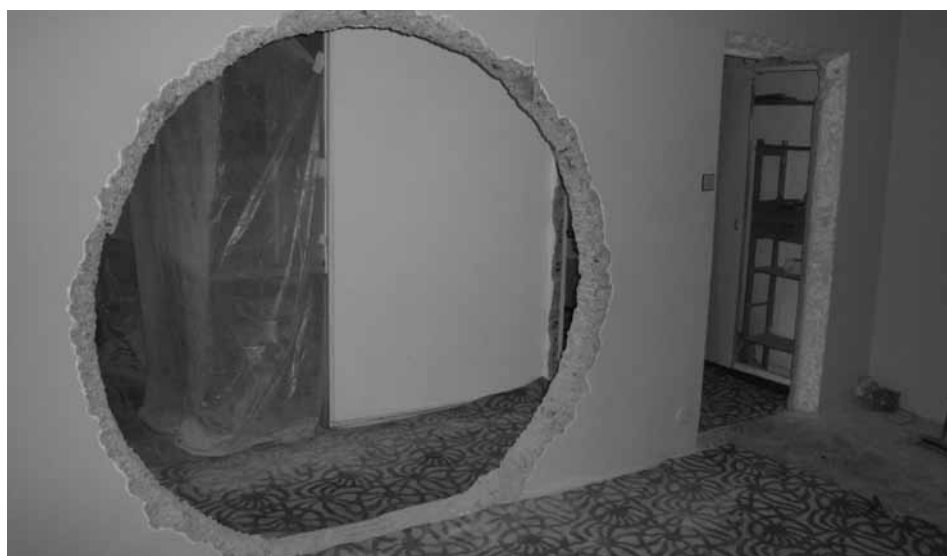
Obr. 1. Vyřezaný otvor průměru 2 m a další oslabení v nosné stěně
