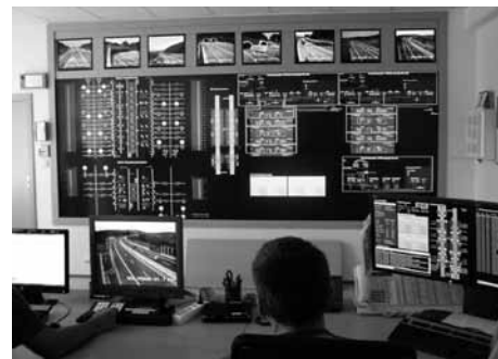
Exkurze na SSÚD Řehlovice – D8; zabezpečení provozu tunelu nejmodernější technikou
