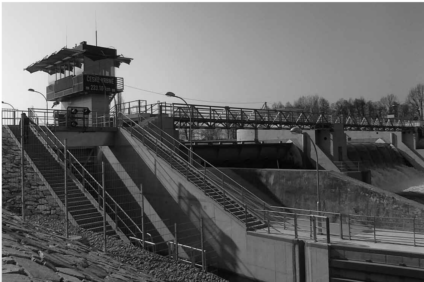
Plavební komora České Vrbné, nový velín a modernizovaný jez.
