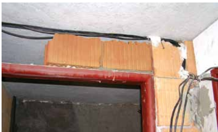
Klínování přček pod stropy, neexistence překladu
