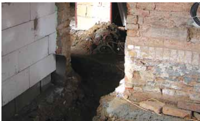
Neexistence hydroizolací pod starým zdívem, napojení pórobetonového zdíva bez provázání – na hladkou spáru; problematické podkladní betony
