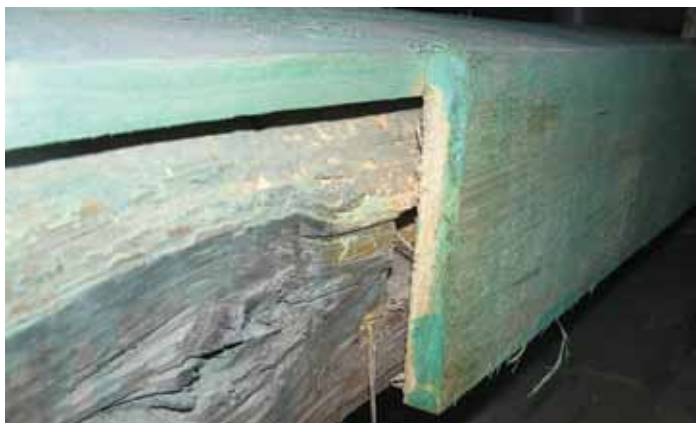
Detail „opouzdření“ degradovaného vazného trámu
