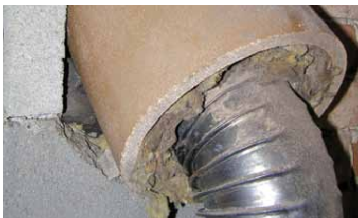
Provizorní propojení vložek Schiedel s lokálním topeništěm kamen v obytné místnosti
