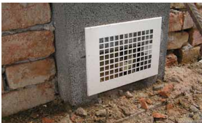
Napojení vložek Schiedel u základu, neexistence horizontálních hydroizolací
