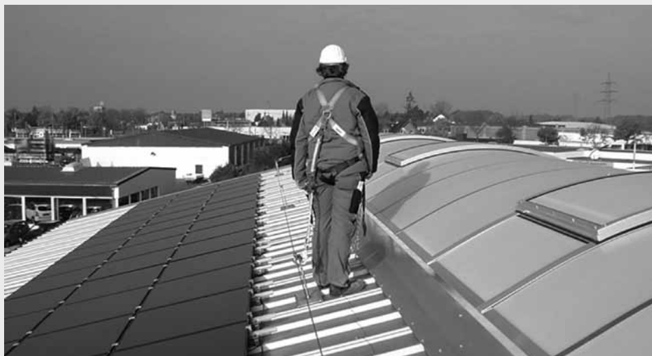
Bezpečnost práce na střeších budov je absolutní prioritou
