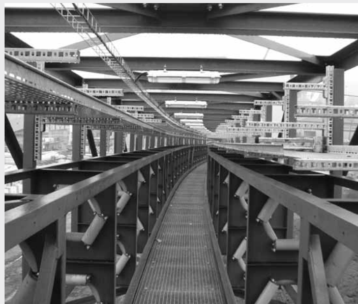
Speciální vysoce ekologický dopravník v elektrárně Ledvice zásobuje uhlím nadkritický kotel 660 MWe
