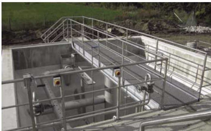
Odkanalizování obce Těšany – čistírna odpadních vod
